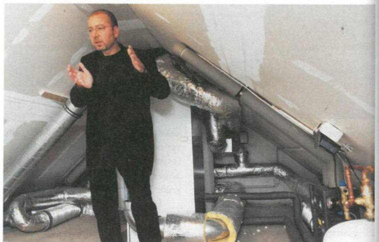
Platz sparend: Erol Serpil hat die gesamte Haustechnik auf dem Dachboden untergebracht.
